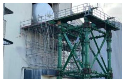
Centrale Nucléaire Ringhals - Suède
