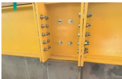
Changement de capacité portante - Station de traitement biologique (13)
